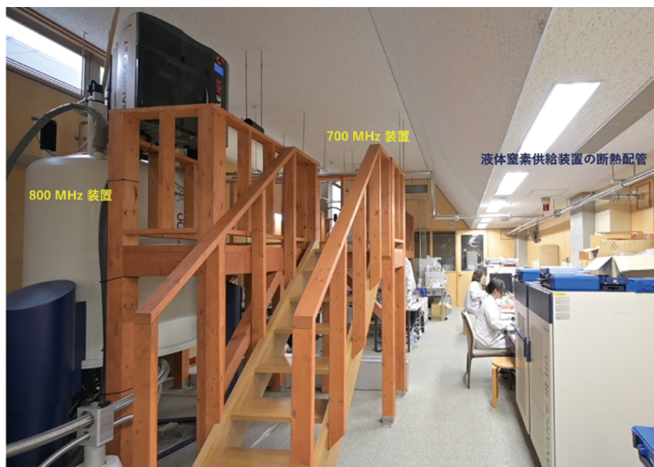
図4 700, 800 MHz NMR装置と天井下の液体N 2 供給ライン
