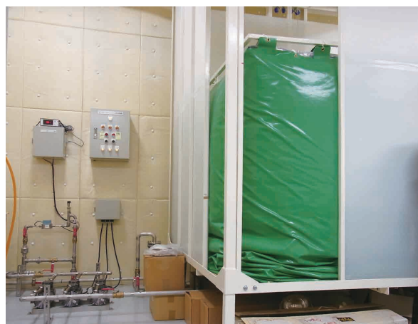
図2 液体ヘリウムの回収ラインとガスバッグ。ガスバッグがいっぱいになると、地下に埋め込まれた回収ラインを通して超低温物性実験施設に自動転送される
