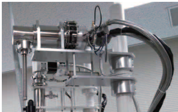
凝縮ユニット
